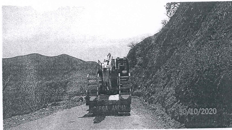
Fotografía N° 2: Movilización de excavadora 320 2L CAT desde Cajamarca a la obra. Coordenadas: 740047.98 E, 9195432.66 N
