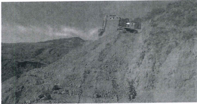
Fotografía N° 6: Acumulación y Apilamiento de material en cantera del señor Santos Medina Ubicada Progresiva KM 5+354.72 en las coordenadas: 735380.92E 9186457.01N.
